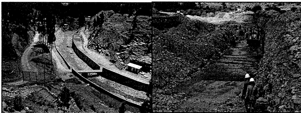
DEFENSA RIBEREÑA DEL RIO ICHU EN YAULI - SERVICIOS DE PROTECCIÓN DE LAS ÁREAS AGRÍCOLAS Y URBANAS EN CALLQUI CHICO Y GRANDE HVCA
